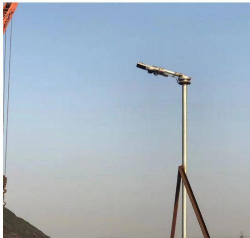
图 4-7 原喷淋系统照片
